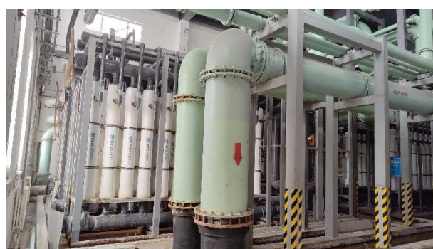
超滤膜组装置
